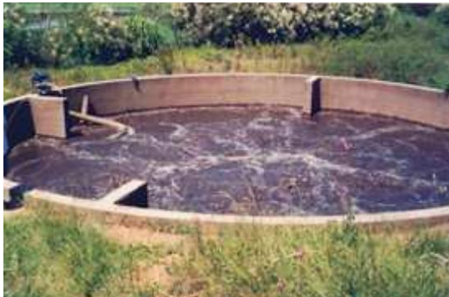
Figura 12 - Tanque de lodo ativado
