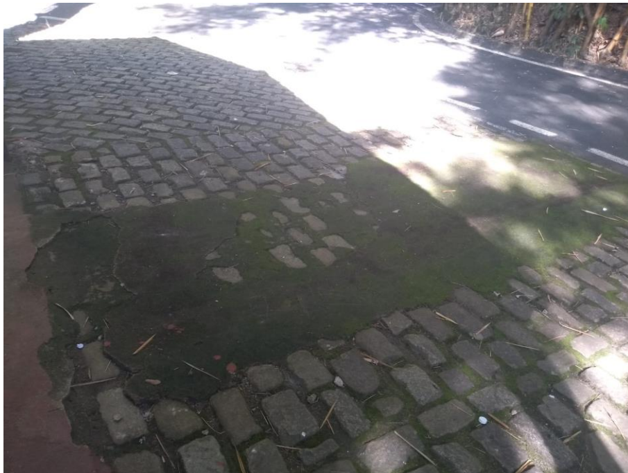
Figura 66: Exemplo de rampa de paralelepípedos, com tentativa de cobrir uma parte dela com cimento
