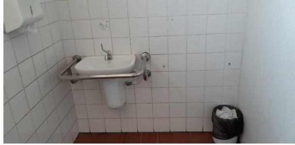
Figura 84: Banheiro inclusivo do Museu Catavento
