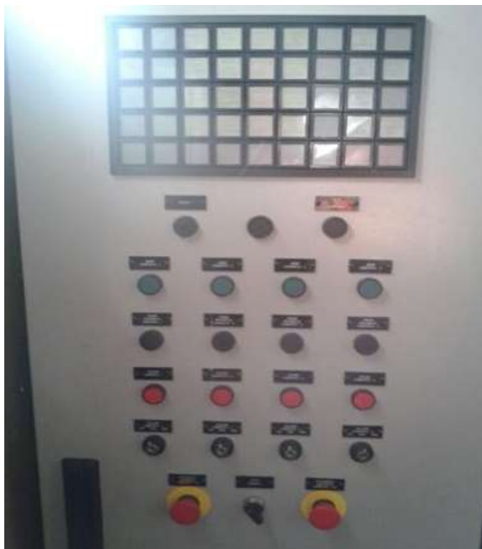
Figura 13 - Vista frontal do painel de controle principal.
