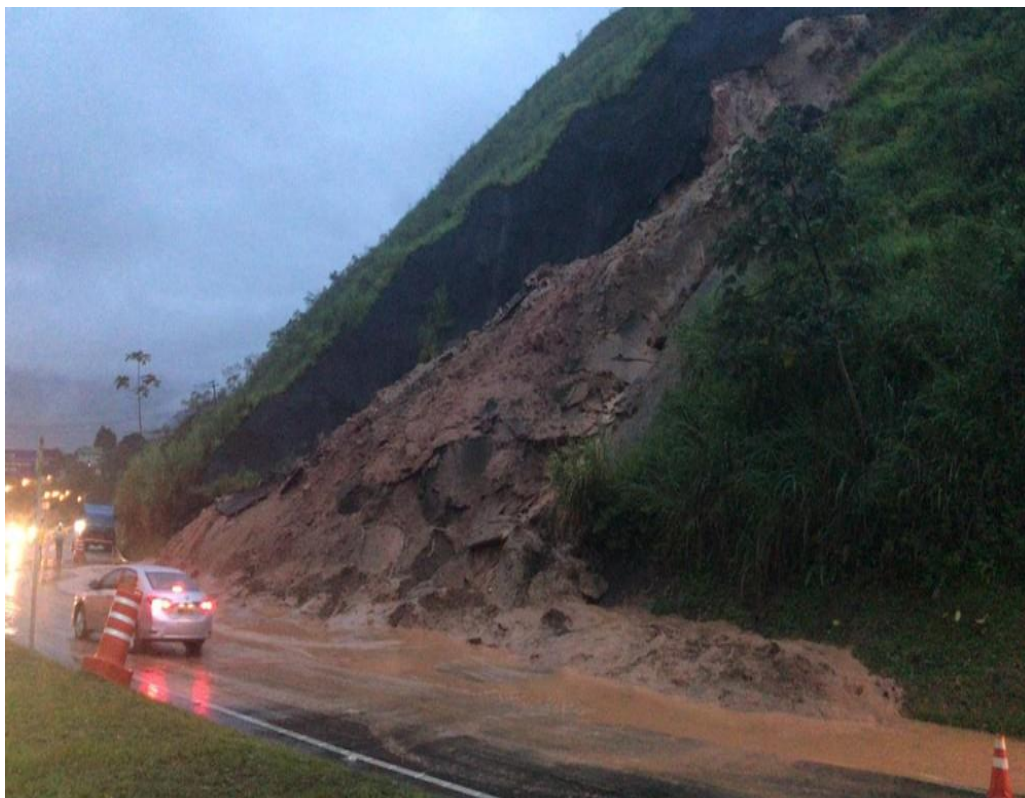
Figura 23 - Escorregamento na Rodovia Rio - Santos, em Angra dos Reis, em 2019. Fonte: G1 (2019).
